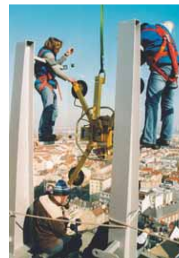
Vorsicht bei gefährlichen Bauarbeiten: Ziviltechnikergesellschaften sind zukünftig für Unfälle strafrechtlich verantwortlich.
